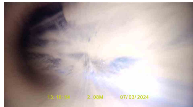
RWDP 5X_68404e3f-23d1-4bb0-ab65-89829c7d6252_20240320_085 048_607.jpg, 00:00:58, 2.08 m Line deviates left
